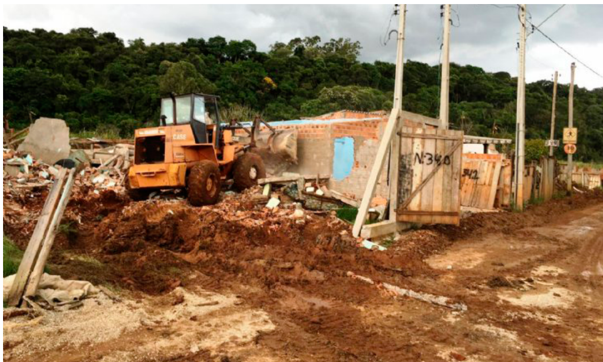
Imóveis foram construídos de forma irregular às margens do córrego do Aranha
