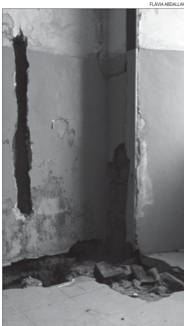
Estrutura do prédio está comprometida
